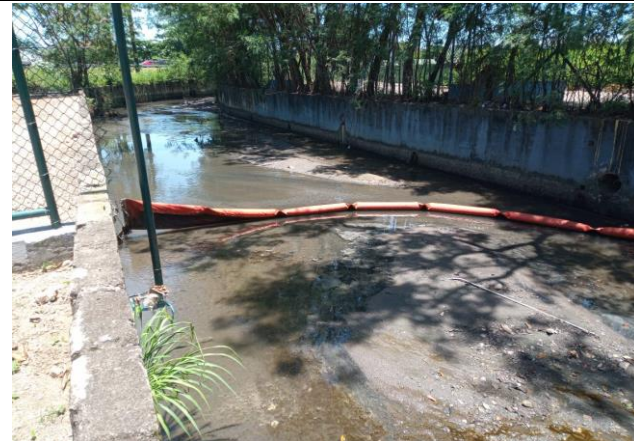
ECO 17 – CANAL DA VILA DO MARUÍ
