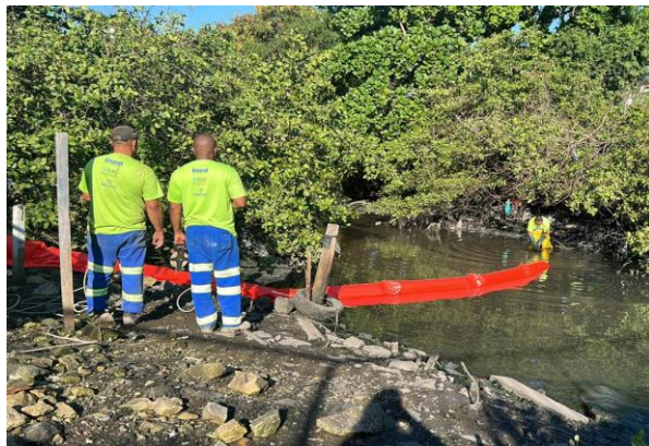
ECO 17 – CANAL DA VILA DO MARUÍ
