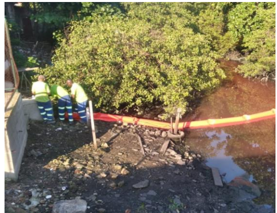
ECO 17 – CANAL DA VILA DO MARUÍ
